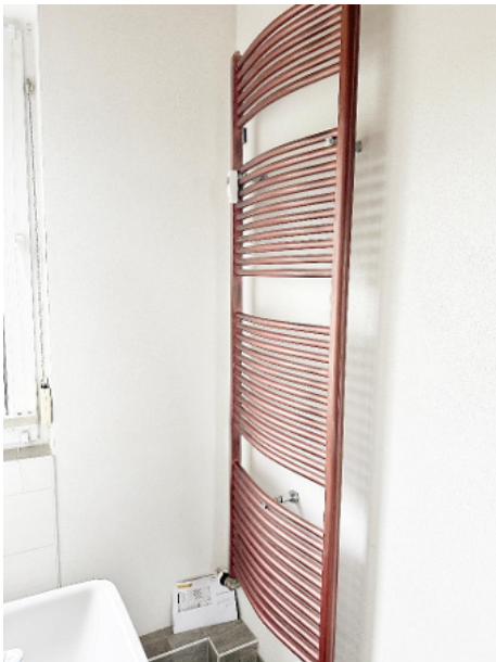
Tageslichtbad mit Raumsparwanne, Toilette, Waschtisch und Handtuchheizkörper
