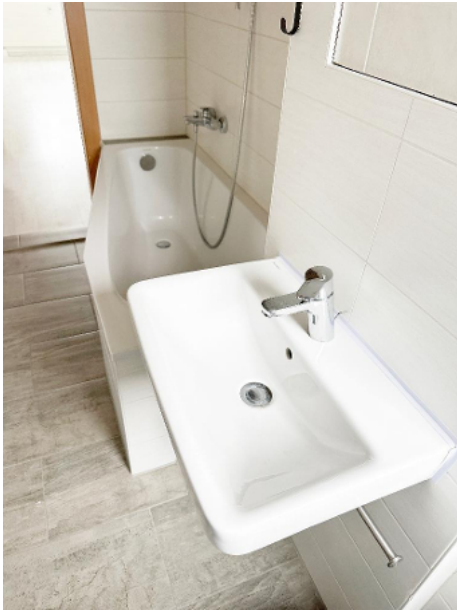
Tageslichtbad mit Raumsparwanne, Toilette, Waschtisch und Handtuchheizkörper
