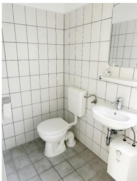
Toilette mit Waschbewcken und WC
